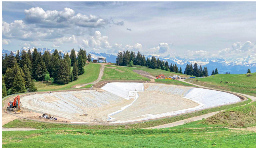
Chantier de remplacement (juin 2026) de l'étanchéité de la retenue du col de la Ramaz par une géomembrane certifiée
